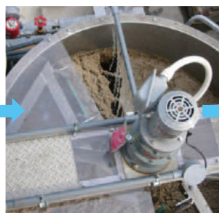
油分濃縮分離 (浮上濃縮槽)
